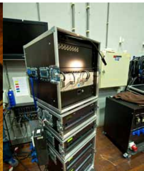
Het versterkerrack op het linker zijtoneel van de grote zaal. De d&b D12 versterkers onderin krijgen hun signaal via het Dallis frame bovenin.
